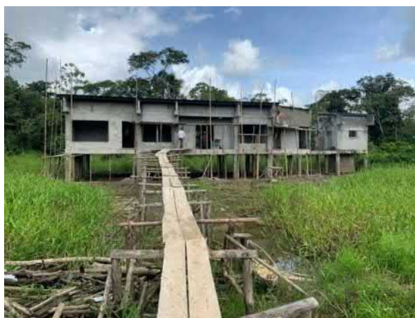
Terminal Aeroportuaria Vigía del Fuerte Urabá, Municipio de Vigía del Fuerte Secretaría de Infraestructura Física (SIF) - Gobernación de Antioquia
