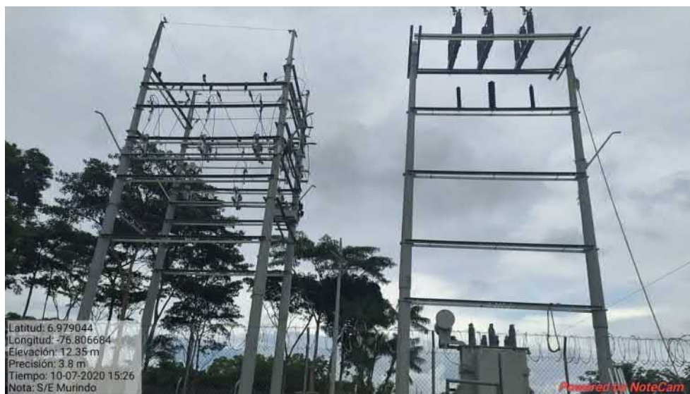
Proyecto “Construcción interconexión eléctrica Casabomba – Murindó – Vigía del Fuerte” Urabá, Municipio de Murindó. Subestación de Energía Eléctrica “Murindó”. Gerencia de Servicios Públicos – Gobernación de Antioquia
